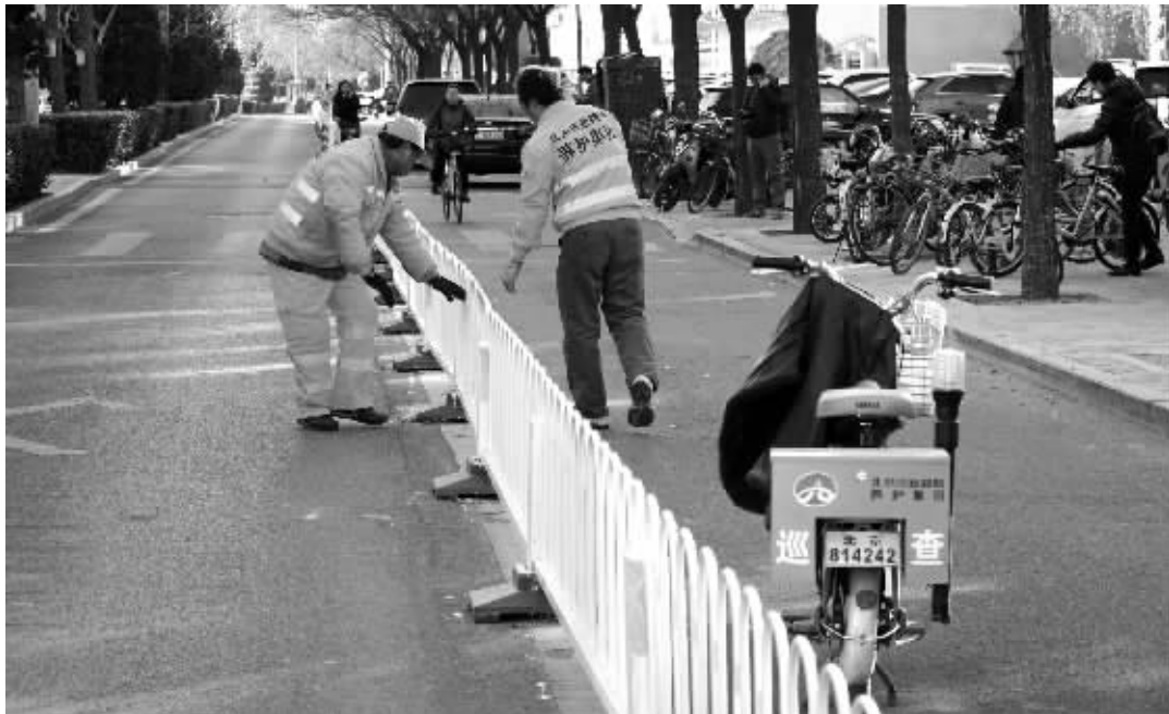
工人师傅正在朝阳门外大街摆放自行车道与机动车道之间的隔离护栏。
