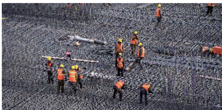
▲延崇高速妫水河隧道施工现场，工人进行作业的地方就是妫水河。
