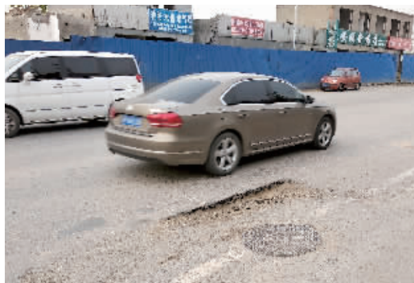
险 ▶通州区嘉创路距康化路南口大约400米的位置,路面上出现一个坑,给骑车人和机动车行驶带来危险。王青 / 摄
